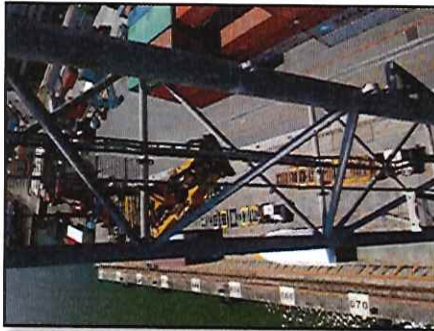
Local: Lança Item # 56: faltando grade da passarela de acesso para a manutenção da lança.
