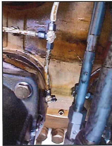
Local: Sala do Guincho Item # 25: Vazamento no tubo de lubrificação dos freios, dromo de carga pesada ( heavy duty ).
