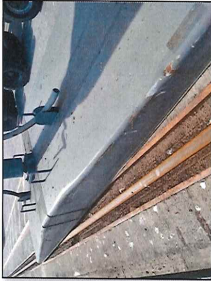
Local: Estrutura Rodante Item # 02: Pontos com corrosão e amassados nas sapatas das patolas de sustentação. Status: corrigido.
