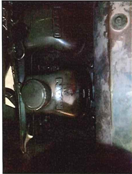
Local: Sala de Máquinas Item # 15: vazamento de óleo pelas tampas de válvula do motor diesel.
