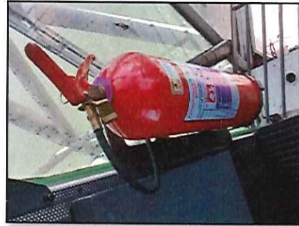
Local: Cabine Item # 62: extintor da cabine superior sem a abraçadeira do suporte.
