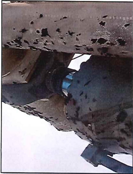
Local: Lança Item # 52: cilindro da lança com pequeno vazamento de óleo pela tampa.
