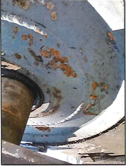
Local: Torre Item # 46: pontos de corrosão na estrutura das polias da torre.
