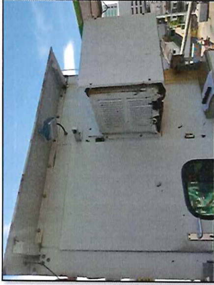
Local: Cabine Item # 58: cabine de operação com pontos com corrosão.
