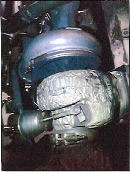
Local: Sala de Máquinas Item # 16: turbina do motor com vazamnto de gases de escape.
