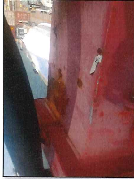
Local: Rotator Item # 65: pontos com corrosão na estrutura do rotator.
